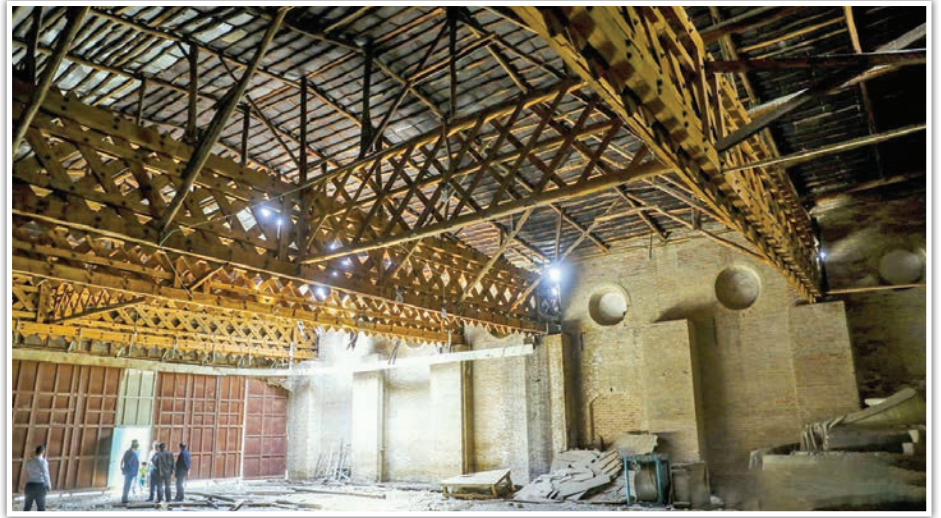
▲ ایمن سازی و رفع خطر از آشیانه نخستین فرودگاه کشور از سوی شرکت توسعه فضاهای فرهنگی در حال انجام است.
