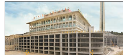
تیرماه ۱۴۰۲ عملیات اجرایی پایدارسازی گود جانبی مرکز همایش‌های برج میلاد شروع شد. آبان ۱۴۰۲ مرحله اول عملیات پایدارسازی به پایان رسید.
